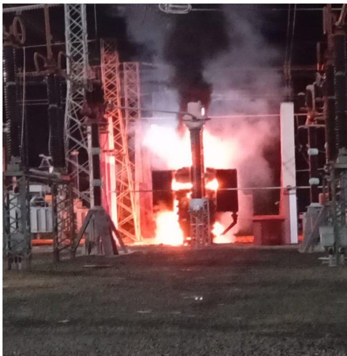
REATOR 09 – 500KV – SE P. DUTRA.
